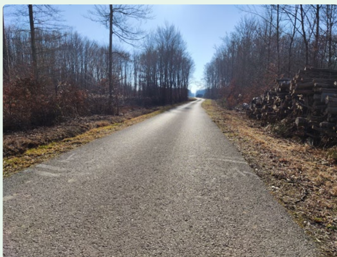
Slika 18: Horizontalna talna označba na občinski javni poti JP 669081 (Logarnica - Sv. Martin - Varga), ki opozarja na prisotnost kolesarjev na vozišču; označbe so delno zbledele in jih je potrebno obnoviti za zagotavljanje vidnosti in varnosti
