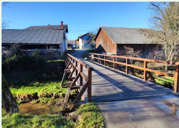
Slika 26: Leseni povozni most med državno R3-724/4210 Berkovci - Kobilje in občinsko cesto LC-169031 (Kobilje) - most je še v uporabi, vendar zaradi dotrajanosti in konstrukcijskih omejitev smiselno razmisliti o njegovi sanaciji oziroma nadomestitvi z ustrežnejšo trajno rešitvijo
