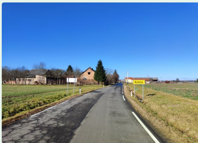
Slika 24: Državna regionalna cesta R3-724/4210 Berkovci - Kobilje pred vvhodom v naselje Kobilje - vidno poškodovano in razpokano vozišče
