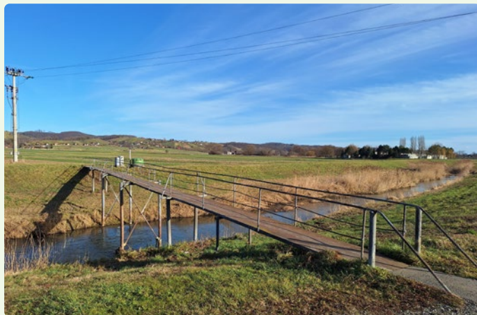
8. ábra: A Ledava folyón átívelő híd Hárasmalomban fontos összeköttetést jelent a Ledava folyó bal és jobb partja között, azonban jelenlegi rossz állapota miatt sürgős felújításra vagy cserére szorul a gyalogosok biztonsága és a helyi hozzáférhetőség érdekében.
