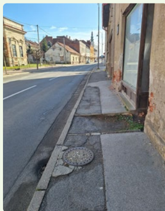
3. kép: Nem megfelelően kialakított járda aszfalozott javítófolttal, kiálló ellenőrző aknákkal és magasságkülönbségekkel – akadály a mozgáskorlátozottak számára
