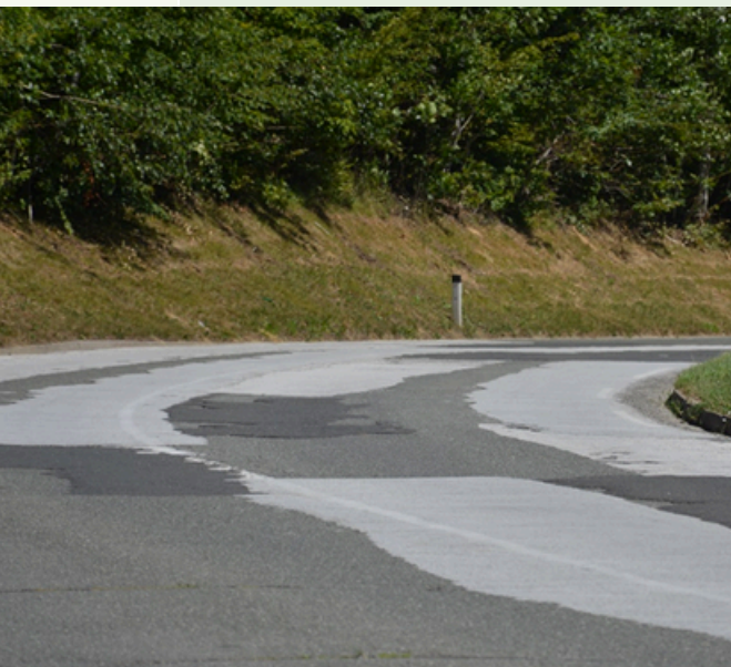
Slika 11: Slabo stanje in poškodovanost vozišča na državni cesti, občina Destrnik
