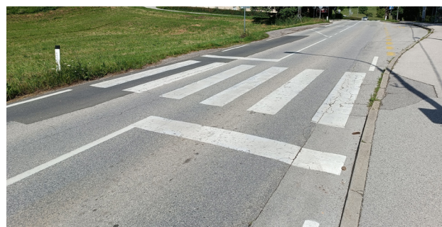
Slika 23; Eden od pomanjkljivo urejenih prehodov za pešce, ki je potreben nadgradnje (na sliki prehod za pešce na Raičevi ulici pri avtobusnem postajališču).
