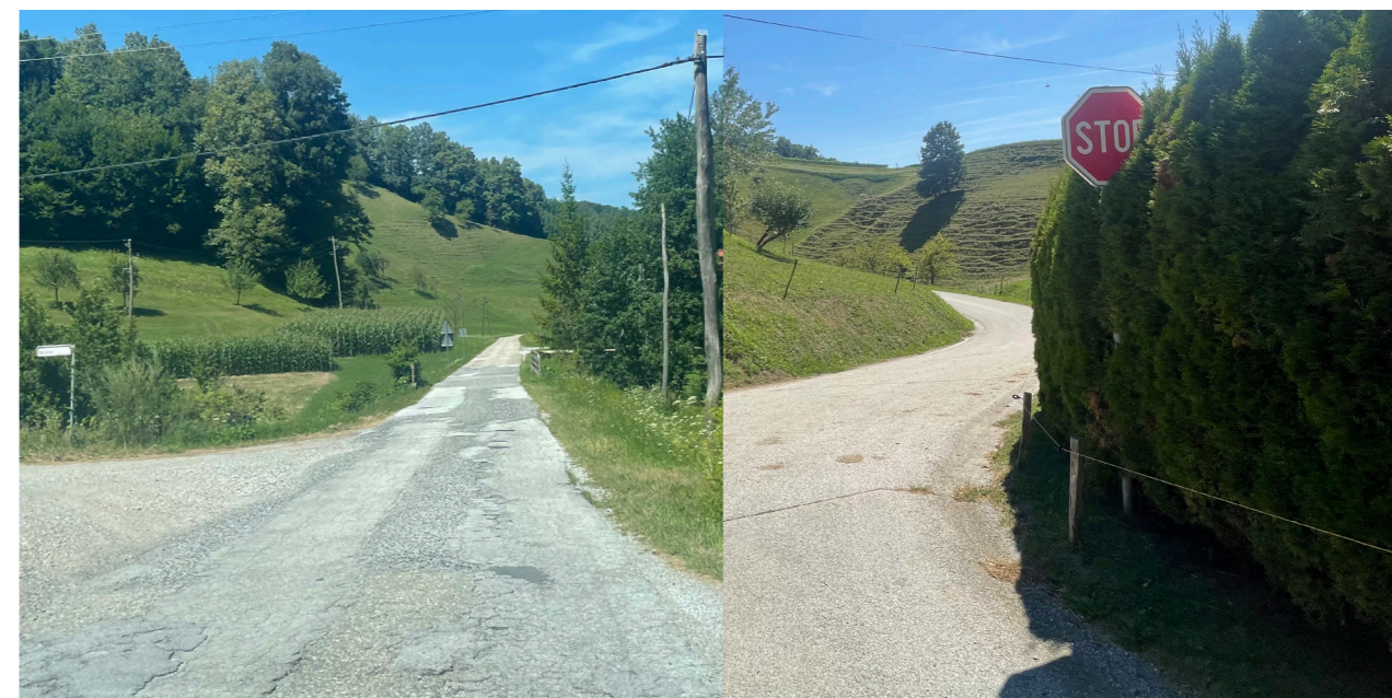
Slika 21 in 22: Dotrajano cestišče in nevarna zasaditev grmovnic in drevesnic v varovalnem pasu ceste in v preglednem polju vozila na glavno prometno smer. Čiščenje obcestnih preglednih berm in zagotavljanje preglednosti je del aktivnega vzdrževanja lokalnih cest.
