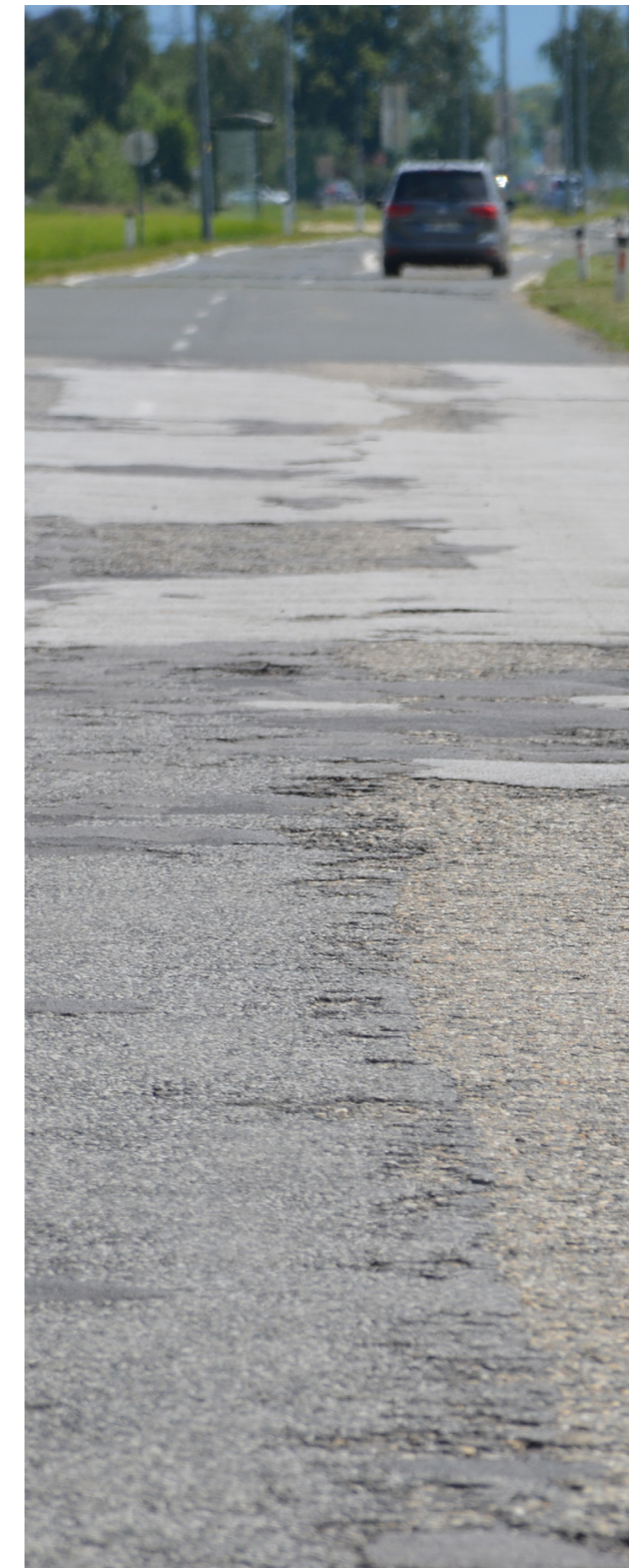
Slika 9: Letališka cesta je v slabem stanju in potrebuje temeljito rekonstrukcijo
