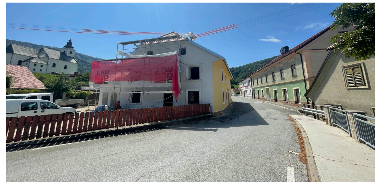
Slika 16: Takšna "ureditev" predstavlja varnostno tveganje za pešce in vozila, saj ni jasne ločnice med prometnimi površinami in objekti. Ozka cesta omejuje pretočnost, še posebej pri srečevanju vozil.
