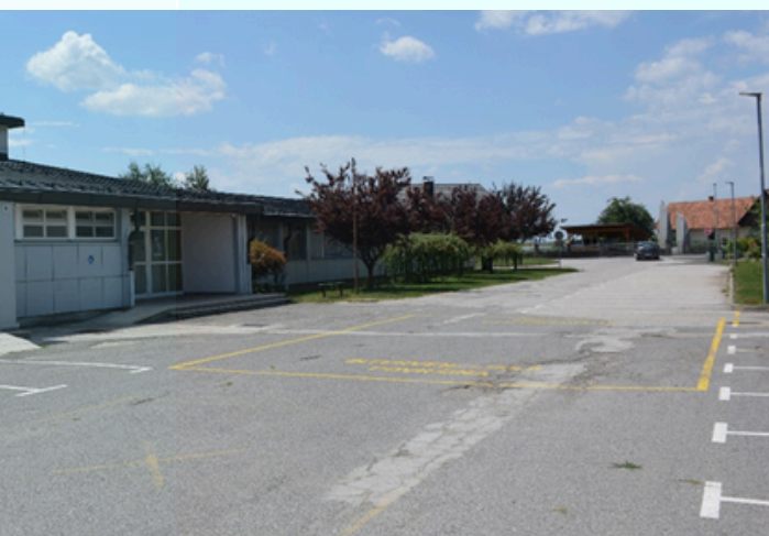
Slika 19: Slabo vzdrževane prometne površine, parkirni prostor ob Osnovni šoli Dornava
